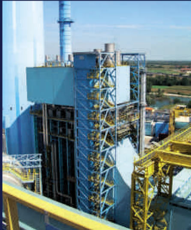
Cassano D'Adda GR5 Power Plant - Italy
